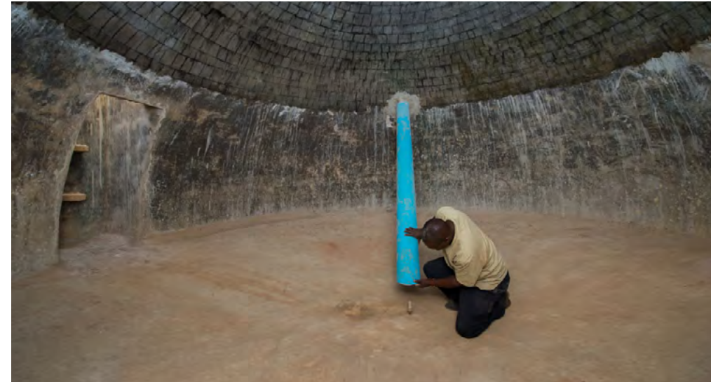
Inside the Chazanga biogas digester
